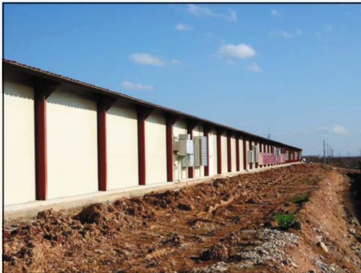
Vista de la fachada con el calefactor y las turbinas de extracción de aire.
