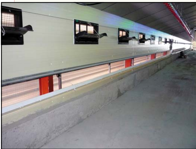
Trampilla Kan'Air y entrada corrida para ventilación túnel.
