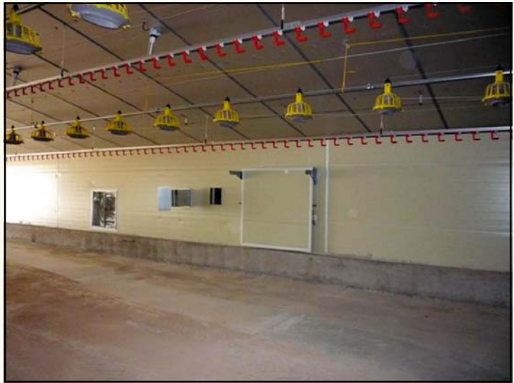
El calefactor y las turbinas, desde el interior.
