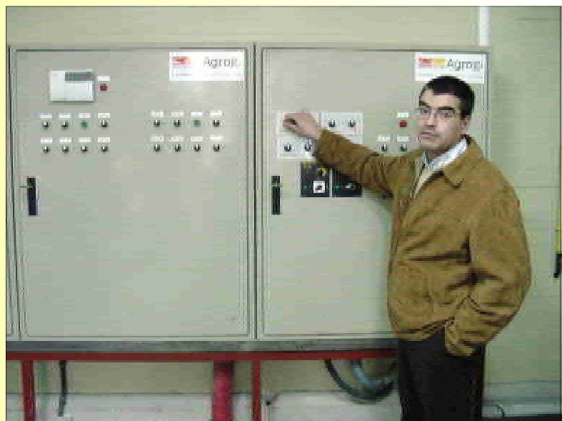
El gerente de AGROGI, Jordi Arnau, comentando algunos aspectos técnicos del cuadro eléctrico.
