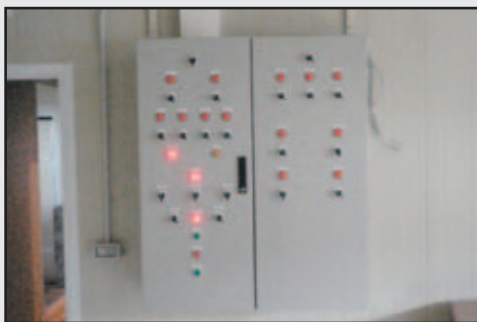
Detalle del cuadro de control del sistema eléctrico. Foto: Esteban Atxa Calvo
