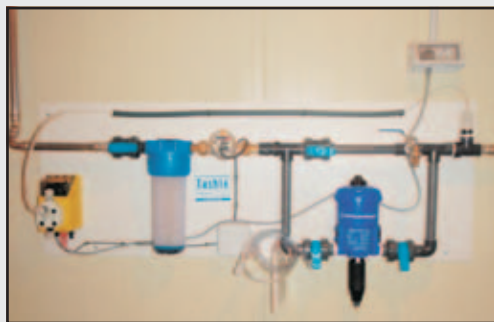
Detalle del sistema cloración del agua y de dosificación de medicamentos. Foto: Esteban Atxa Calvo
